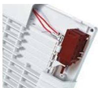
Вентилятор не работает - жалюзи ЗАКРЫТЫ
